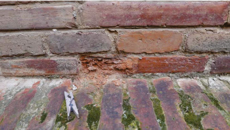
Imagen 19. Fotografías de la degradación del ladrillo
