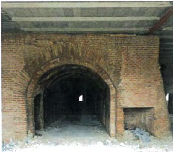
Detalle de los hornos de cocción originales con el nuevo forjado construido sobre ellos.
