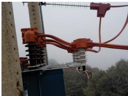
Forrado elementos trafo
